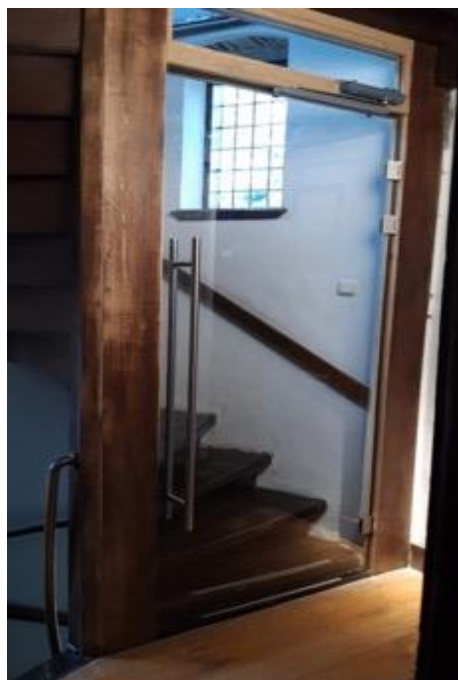
Een van de aangebrachte glazen compartimenteringsdeuren
